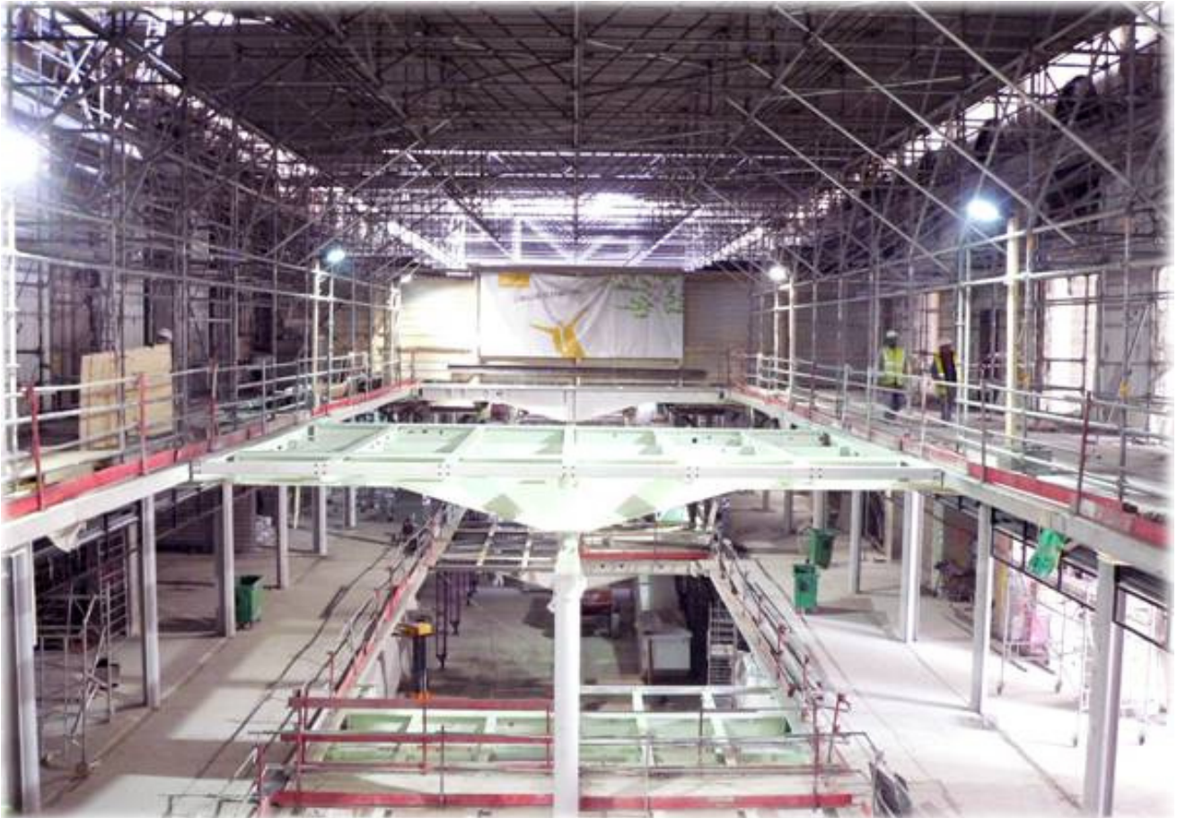
Le cœur de gare, partie centrale de la gare qui abritera le nouvel espace commercial sous la verrière.
